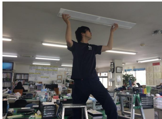
＜電気量削減＞LED交換
